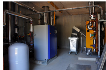
La chaufferie de la piscine Le Triangle
