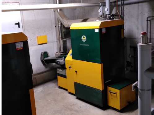
Les deux chaudières chauffent l'école, la mairie, la salle des fêtes et les 2 logements communaux.
