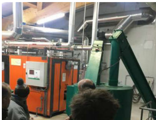
Visite de la chaufferie
